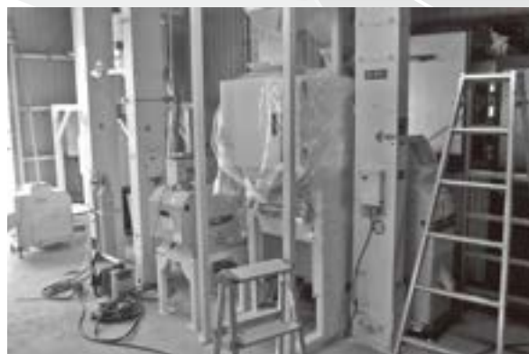
今回導入された精米設備
