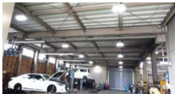
高効率化された工場の照明
